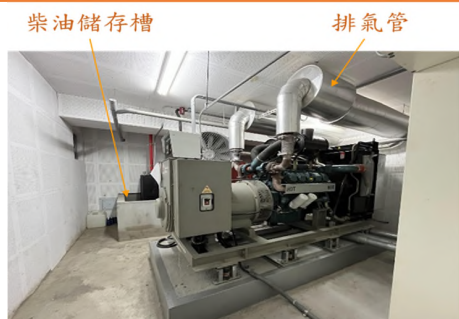
資料來源：林健富提供。 解說圖977-1：柴油發電機組實體圖例
