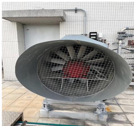
資料來源：林健富提供。 解說圖970-2：屋頂之排風機
