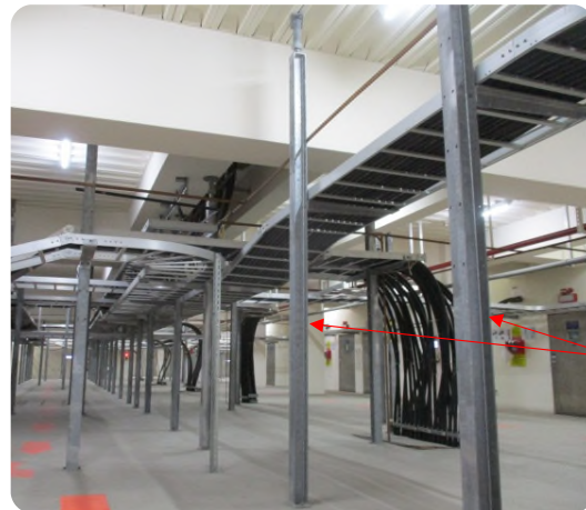
高承載鋼結構支柱可耐重
